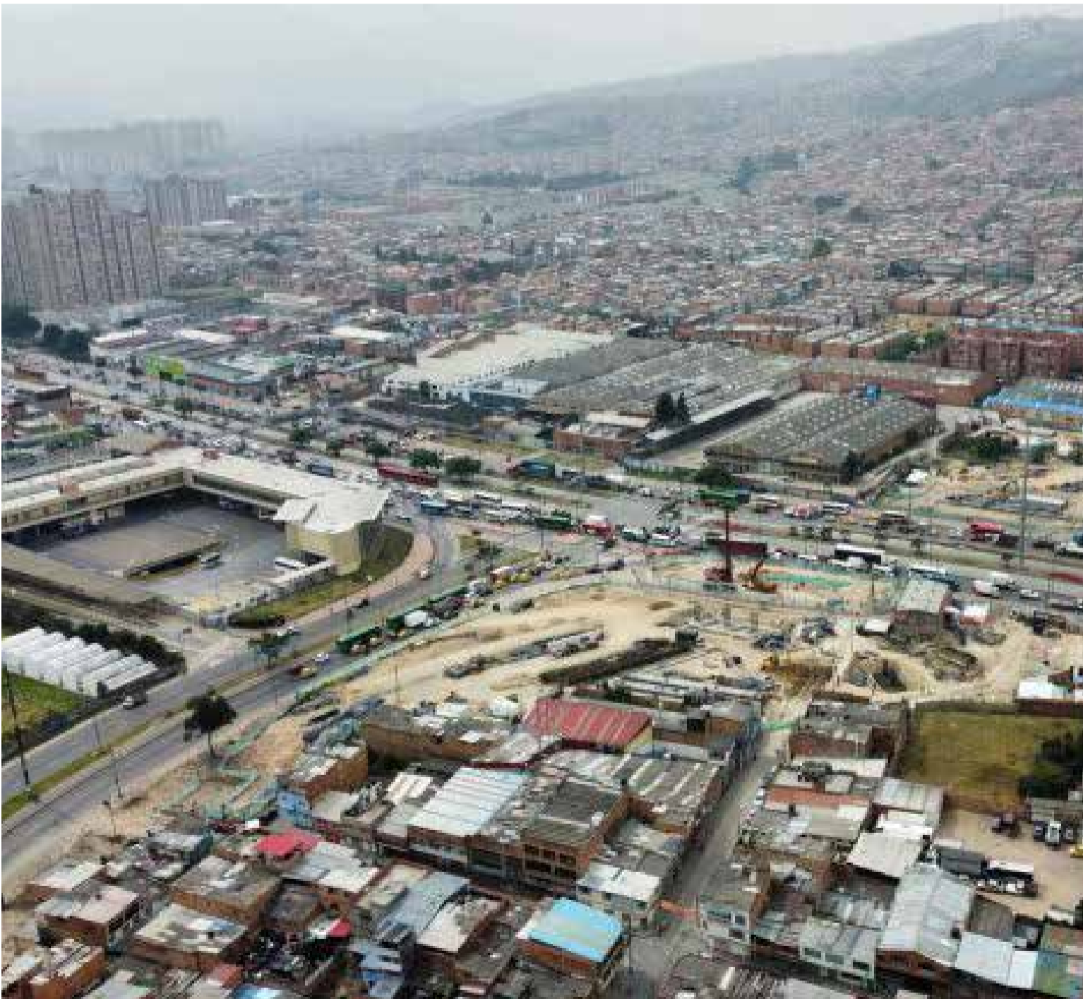
La intersección de la av. NQS con la av. Bosa comenzó su construcción en 2023 y actualmente registra un avance de obra ejecutado del 12.92 % sobre el 12.67 % programado.
